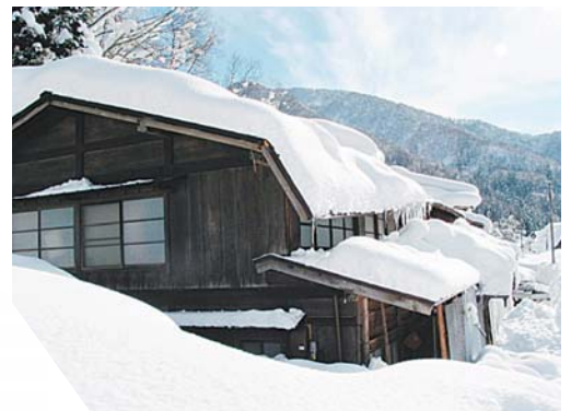
タルキが折れた被害
