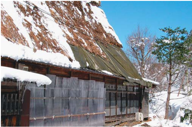
茅屋根がぬけた被害
